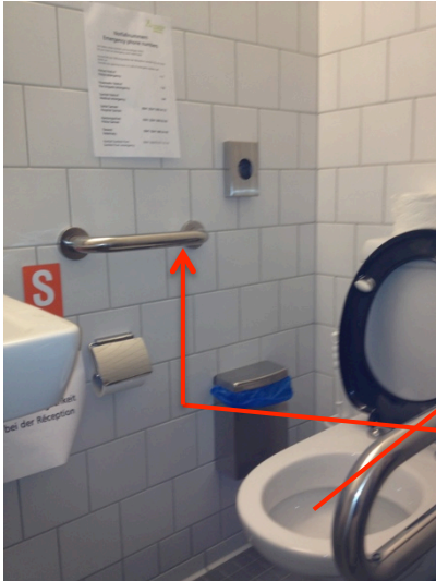
Bild 16 L-Haltegriff fehlt. Klapp- und Wandhaltegriff auf unterschiedlicher Höhe, ungeeignet.
